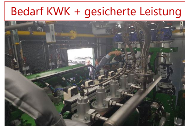
Bildquelle: H 2 -BHKW in Haßfurth (eigenes Foto)
